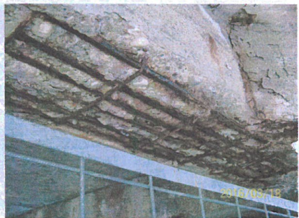
16.kép Az előző kép közelebbről: A betonacél korrózió miatt levált betontakarás és a felszínre került vasbetétek 15-20%-os keresztmetszet csökkenése
