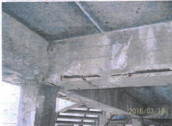
9.kép A beázás miatt megfigyelhető karbonátosodás a gerenda oldalán, és a betonacél korrózió miatt levált betontakarás.
