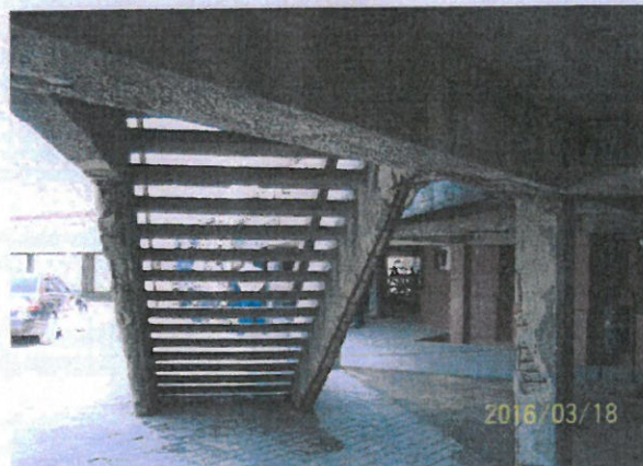
11.kép A D-K-i belső térre vezető lépcső betonkorróziója
