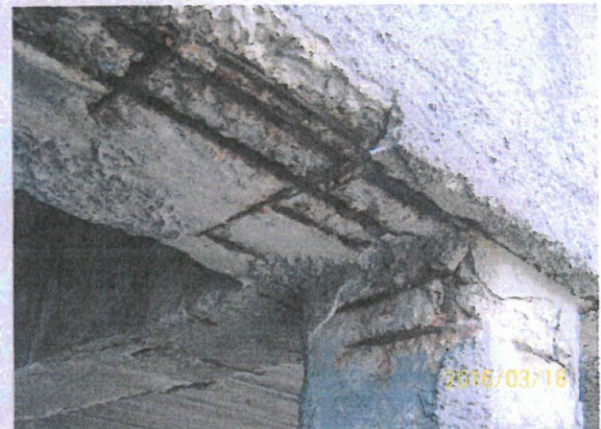
10.kép A betonacél korrózió miatt levált betontakarás és a vasbetétek 15-20%-os keresztmetszet csökkenése.
