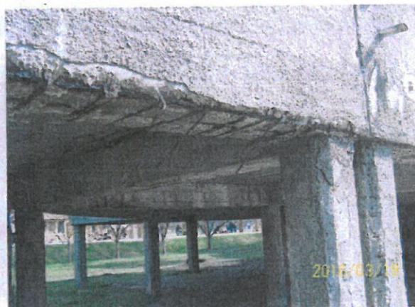
18.kép Az É-i bejárati híd korróziója a dilatációnál: A korrózió miatt elszakadt, kihajtogatott kengyelekkel, a csapadékvíz kivezetés melletti ázás okozta karbonátosodással
