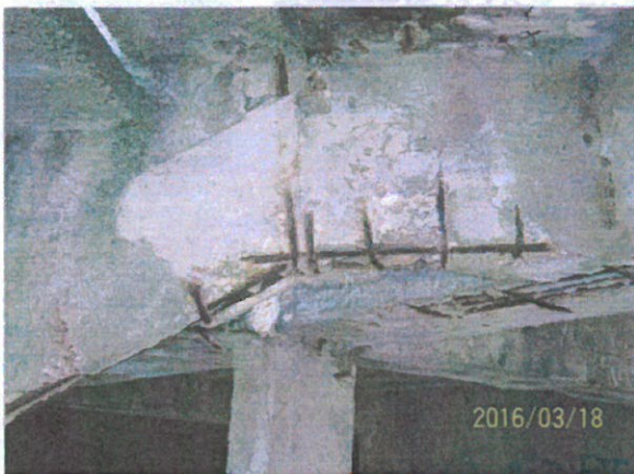
13.kép A 11.kép belső peremgerendájának korróziója, a csekély betontakarás miatt „átrozsdált” kengyelekkel
