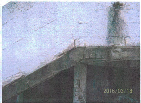
14.kép A 11.képen látható lépcső peremgerendák betonkorróziója a külső oldalról
