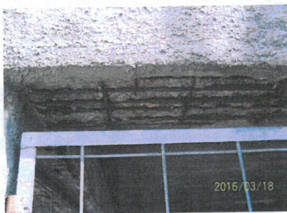
17.kép Az előző két képen látott kiváltógerenda korróziója a támasznál
