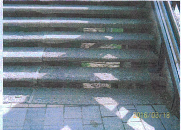
2. kép Az északi bejárati hídra vezető lépcső sérült, szétfagyott lépcsőfokaival
