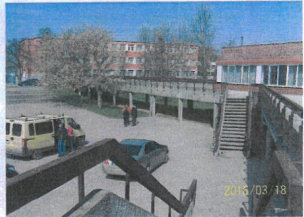
8.kép A belső térre vezető lépcsők és az É-i bejárati híd D-Ny-i irányból
