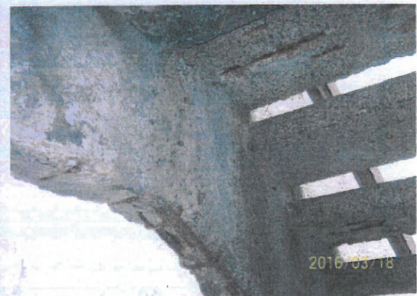
12.kép Az előző képen látható lépcső külső peremgerendájának korróziója, belülről, a gerenda irány törésénél
