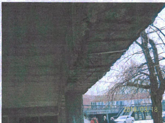
20.kép Szakadt kengyelek a Ny-i oldali a terasz peremgerendán, a dilatációtól D-re.
