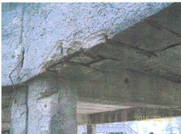
19.kép Dilatáció a bejárati híd K-i oldalán
